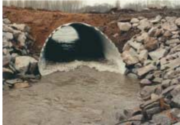
Einbau von Durchlässen in den Leinpfad, Steinmetz bei Eggenstein, Quelle: Fa.Wald & Corbe, Hesch
